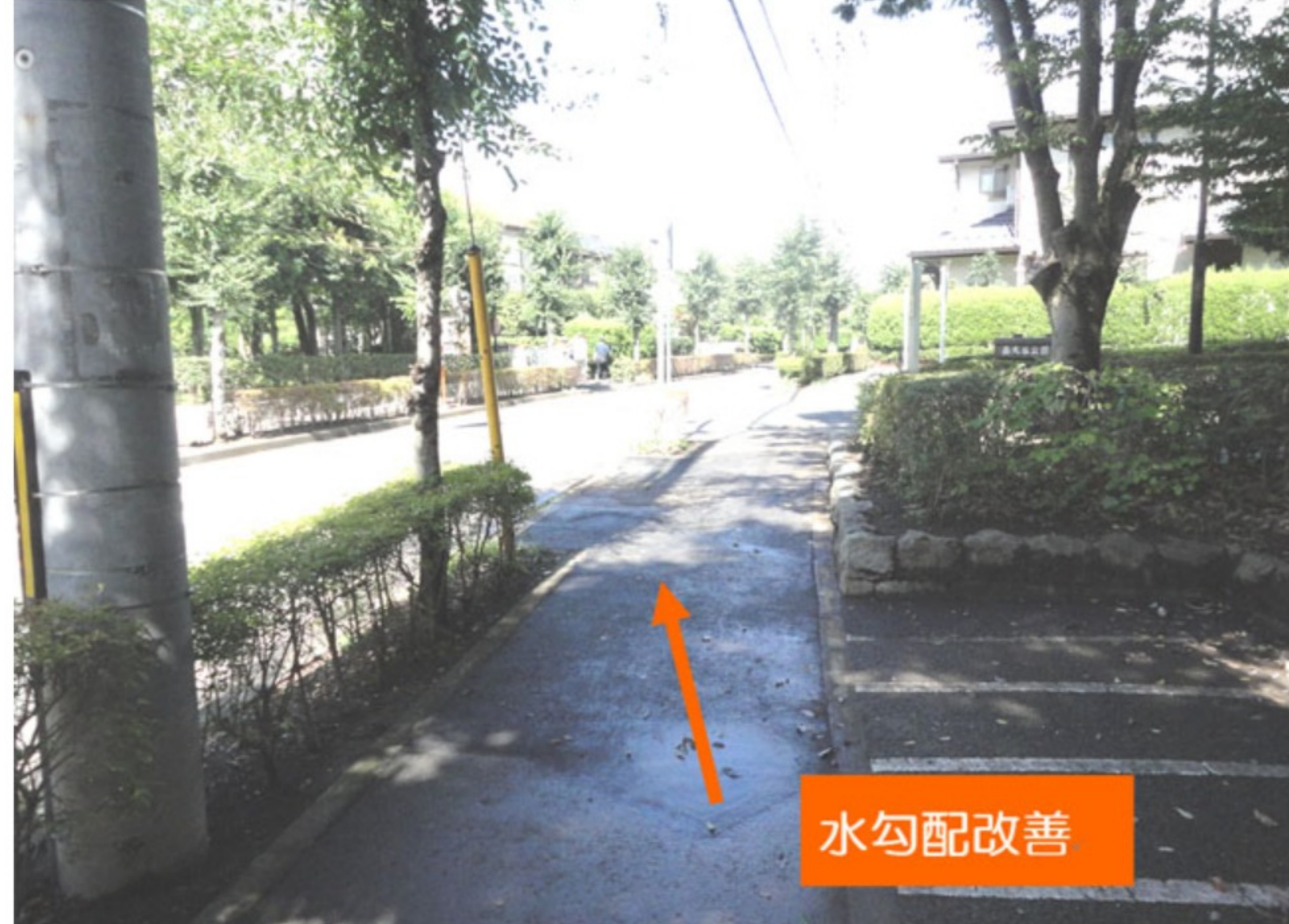
【改良後】強い雨の後でしたが、しばらくして水は排水されていました。H25.9.3撮影
